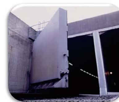
トンネル入り口止水扉 (大日検車場)
