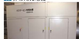
17 非常用発電機
