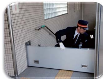
止水パネルの設置状況 (中央線 谷町四丁目駅)
