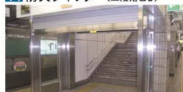
14 防火シャッター(二段落とし)
