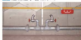
5 連結送水管(放水口)
