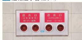
1 連結送水管(送水口)
