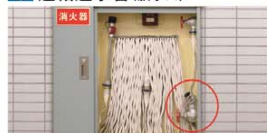
3 連結送水管(放水口)
