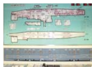
地下線防災監視盤
