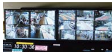
併用軌道監視装置
