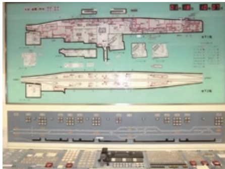
地下線防災監視盤
