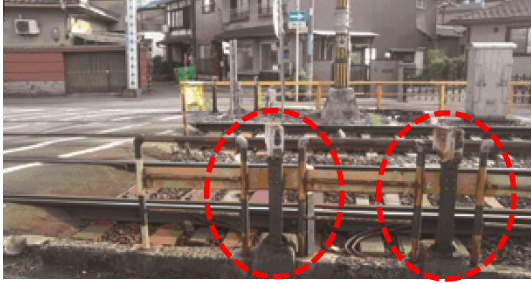
自動車侵入検知装置
