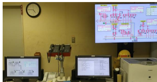
電力管理システム
