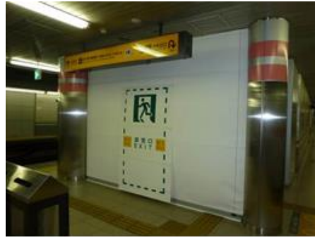
防火防煙シャッターが下りた状態
