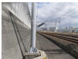
架線区分標識（エアセクションの位置を示す）
