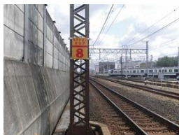
セクションクリア表示板
