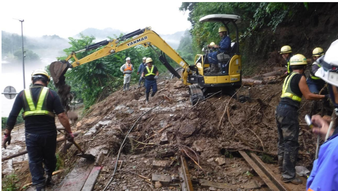
(梅山駅～湯の洞温泉口駅間 土砂流入現場)
