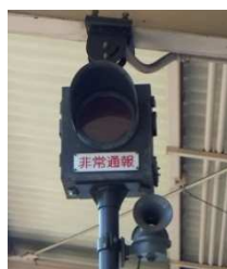
非常通報表示器
