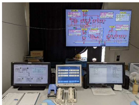
電力管理システム
