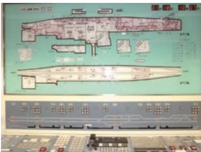
地下線防災監視盤
