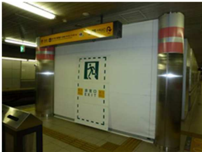
防火防煙シャッターが下りた状態
