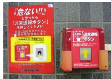
非常通報ボタン
