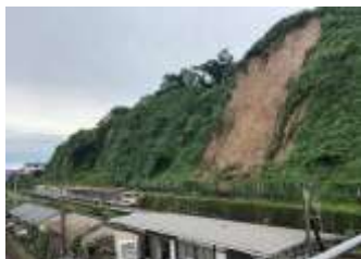
[切取斜面の崩壊]
