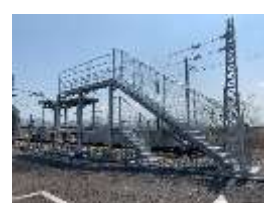
[車両屋上機器点検台]
