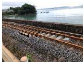
[護岸・路盤流出]
