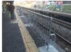
[ホーム固定柵（笹原駅）]
