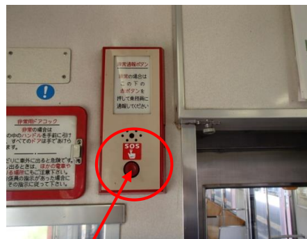
非常通報ボタン
