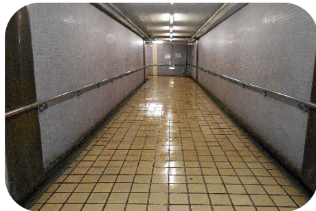
(対策前) 地下鉄駅構内の床 (降雨時に転倒のリスク)
