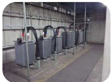
伏見駅配電室 変圧器
