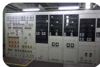
第2栄変電所 主配電盤
