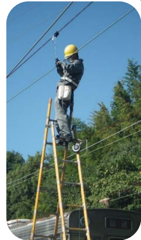
電気設備点検
