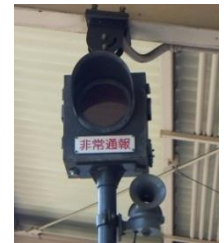
非常通報表示器
