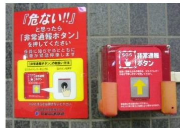
非常通報ボタン
