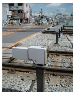
踏切障害物検知装置
