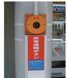
非常通報ボタン
