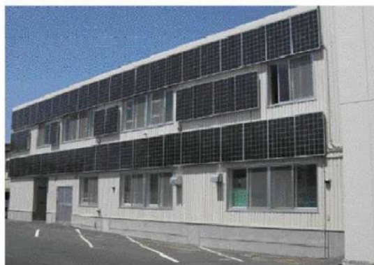
太陽光発電実証設備
