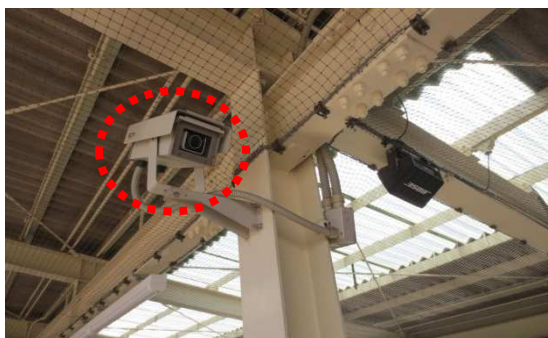
駅構内に設置した防犯カメラ
