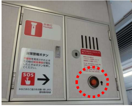
車内に設置してある非常警報ボタン
