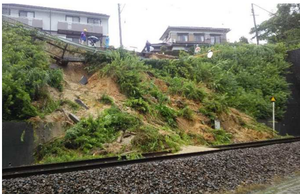
のり面崩落箇所
