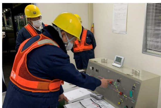
補助制御盤での進路構成
