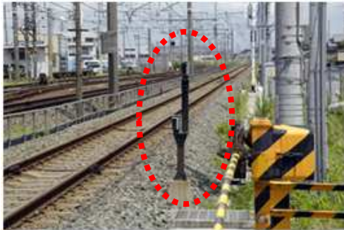
障害物検知装置
