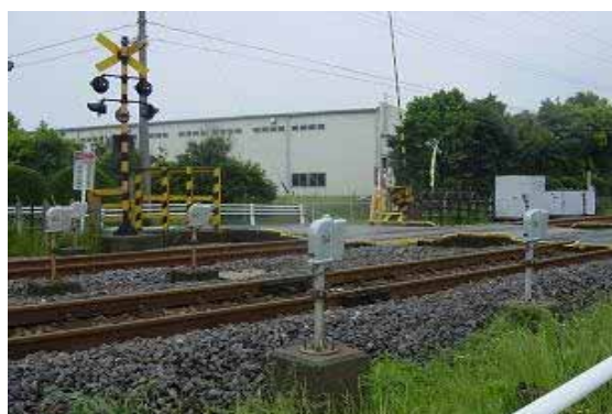
踏切支障報知装置
