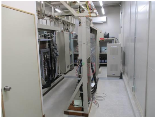
河芸駅継電連動装置更新
