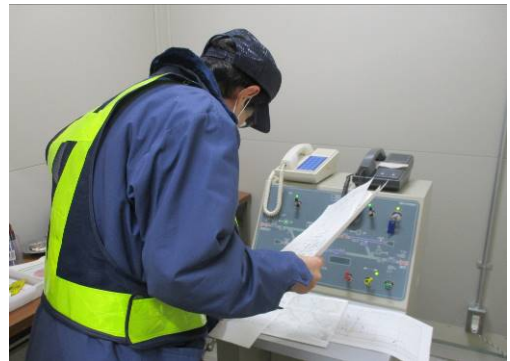
補助制御盤取扱
