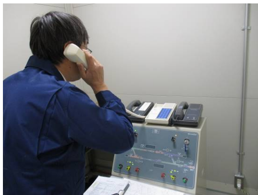
補助制御盤取扱
