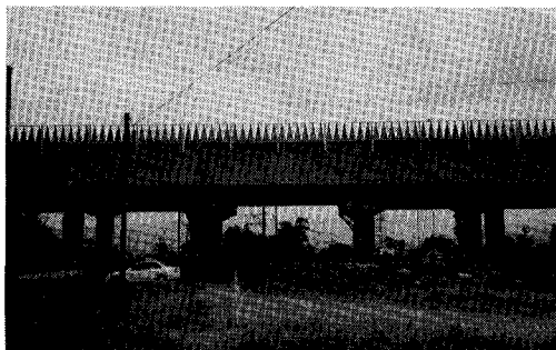
新幹線に設置された「山型防音工」
