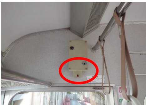
車内非常通報装置
