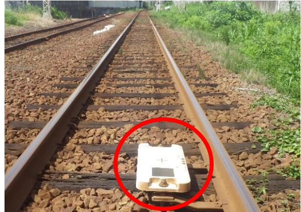
トランスポンダ地上子
