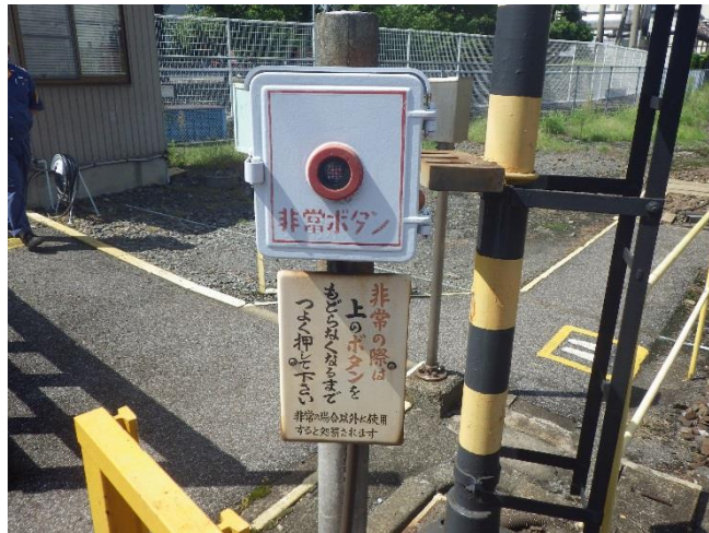
押ボタン式踏切支障報知装置
