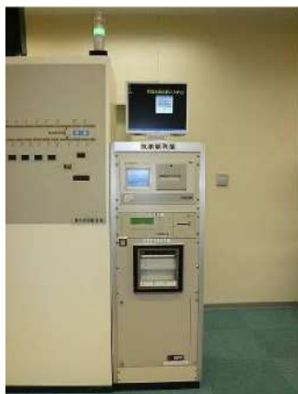
緊急地震速報システム外観
