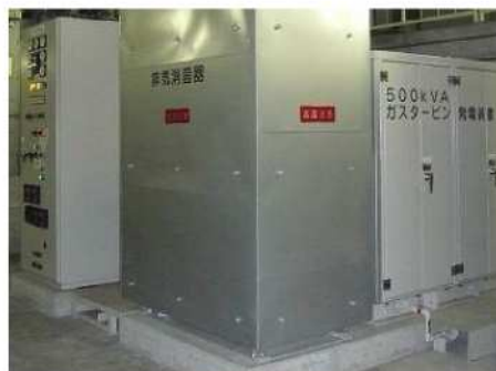
千里中央駅非常用発電設備
