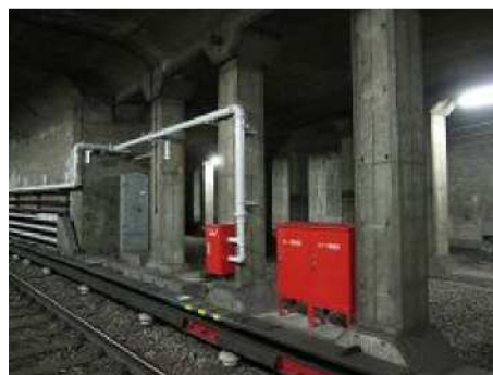
新千里トンネル連結送水管
