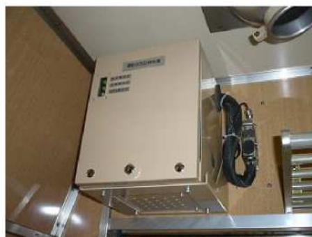
運転状況記録装置
