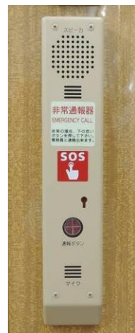
車内非常通報装置
