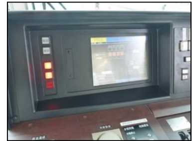
運転台表示装置
