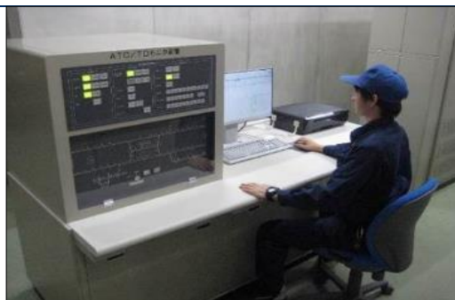
信号保安設備点検の様子
