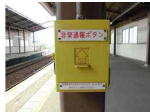
非常通報ボタン
