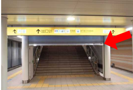
防火防煙シャッター
