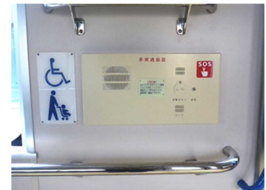
非常通話装置
