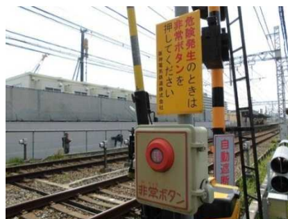
非常押ボタン
