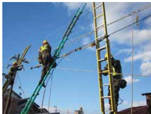
電気事故復旧訓練
