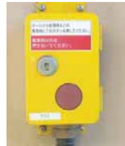
非常通報ボタン
