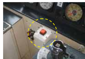
運転士異常時列車停止装置 （EB装置）
