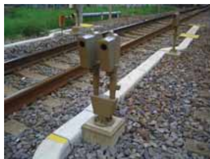
踏切障害物検知装置
