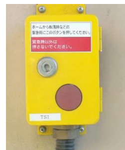
非常通報ボタン
