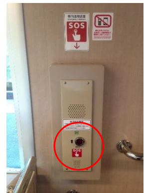
車内通報装置
