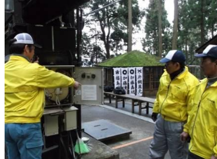
賤ヶ岳（操作盤取扱い研修）
