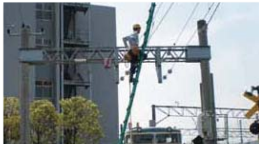
電車線検査実習
