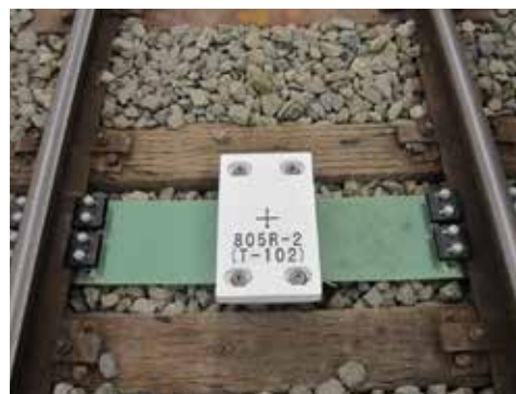
連続速度照査用のATS地上子
