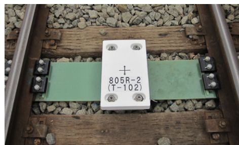
連続速度照査用のATS地上子
