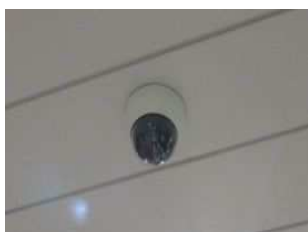
駅構内防犯カメラ
