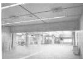
防火シャッター
