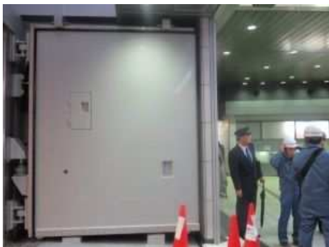
地下街との連絡通路の防水 鉄扉(海岸線ハーランド 駅)
