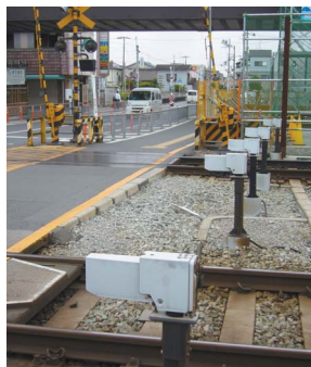
踏切障害物検知装置
