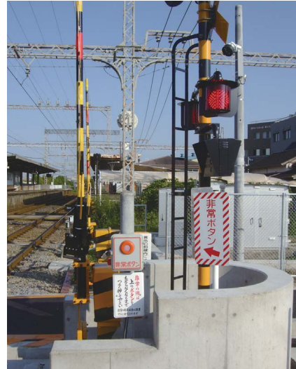
押ボタン式踏切支障報知装置
