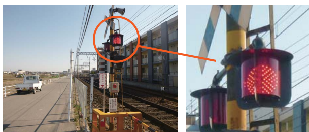
全方向踏切警報灯
