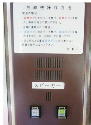
非常発報装置
