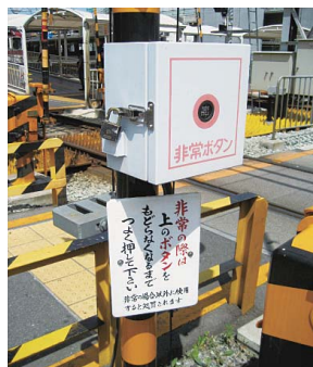
押ボタン式踏切支障報知装置 非常ボタン
