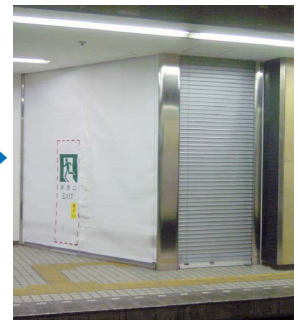
シャッターと耐火スクリーンを下ろした状態
