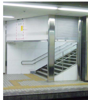
階段防火区画のシャッターと耐火スクリーン（白色）を下ろしている途中
