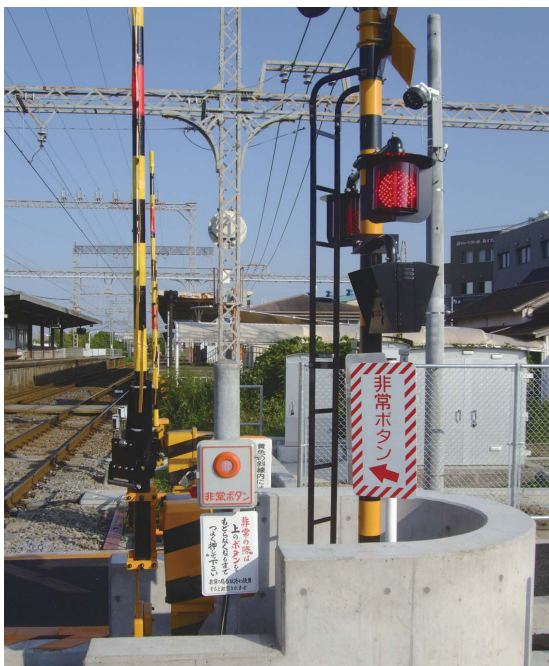
押ボタン式踏切支障報知装置
