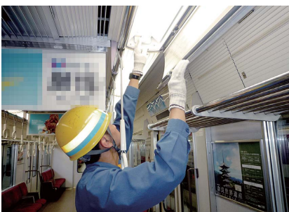
車内蛍光灯の検査
