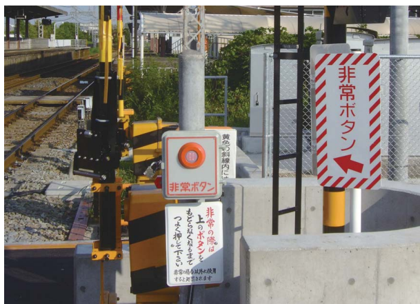
① 押ボタン式踏切支障報知装置
