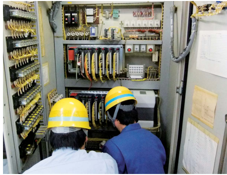
②制御器の検査
