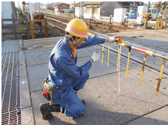
② 踏切保安装置検査
