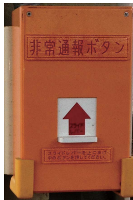
非常通報ボタン
