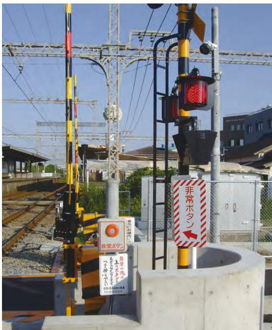
押ボタン式踏切支障報知装置
