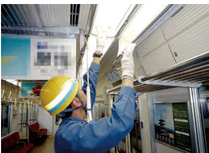
車内蛍光灯の検査
