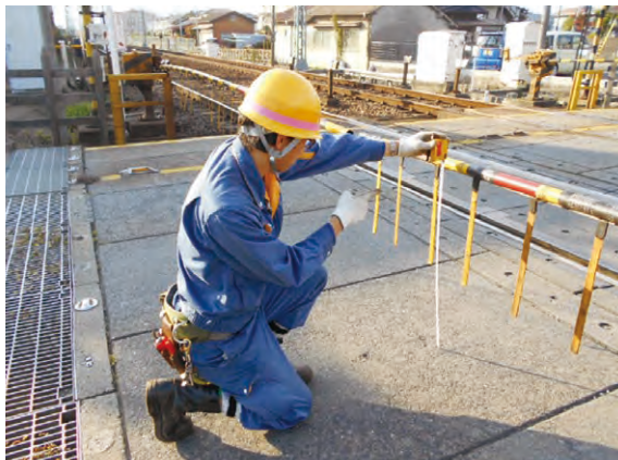
② 踏切保安装置検査
