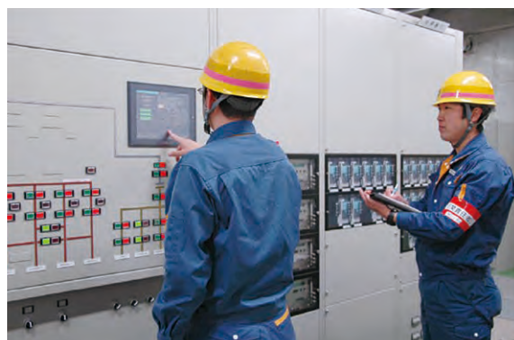
変電所の機器類検査
