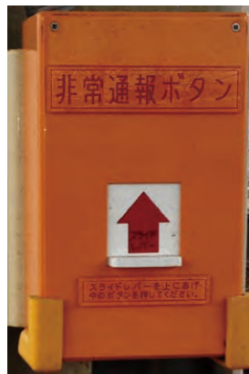
ホーム上の非常通報ボタン
