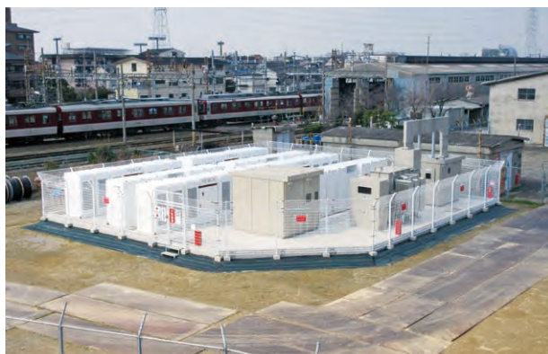
大規模蓄電池
