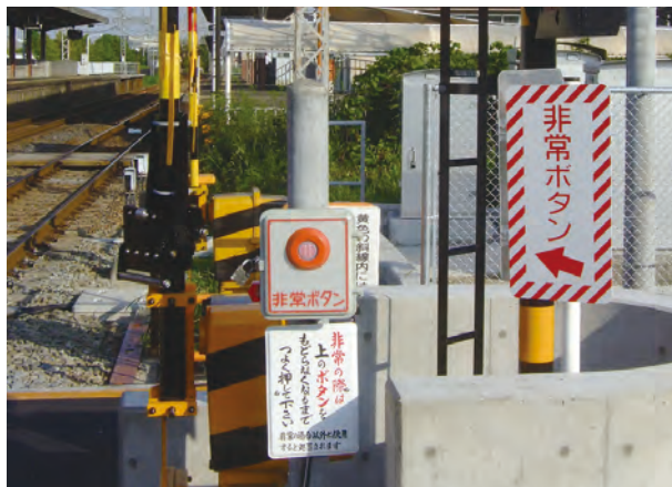
① 押ボタン式踏切支障報知装置
