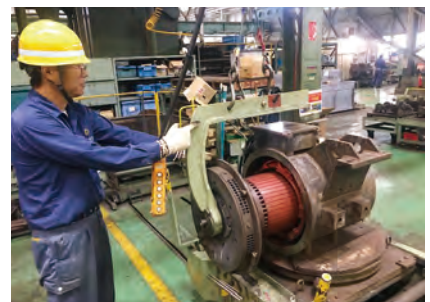
⑪主電動機の検査
