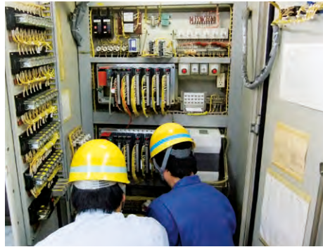
②制御器の検査
