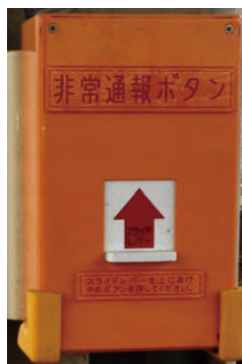
ホーム上の非常通報ボタン
