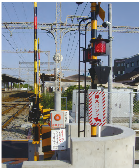
押ボタン式踏切支障報知装置
