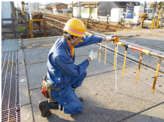
② 踏切保安装置検査
