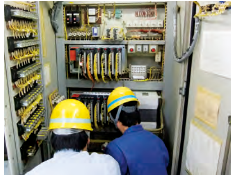
②制御器の検査
