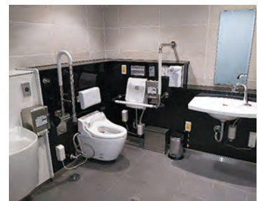
前栽駅多機能トイレ
