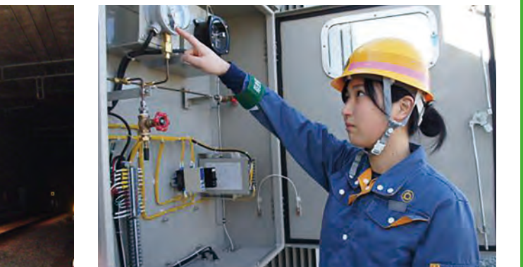
変電所の機器類検査
