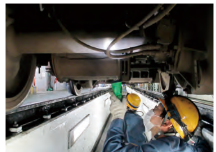
⑧主電動機の検査
