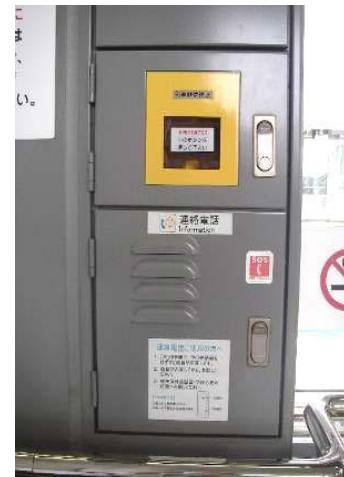
ホームドア横の非常停止ボタン
