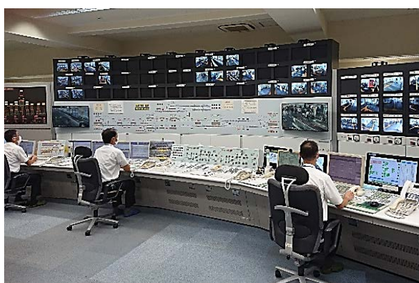
ポートアイランド線総合司令所
