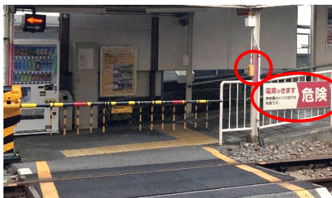
須磨寺駅渡線道に設置している非常通報ボタン
