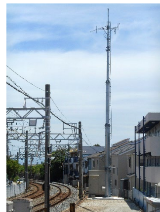
列車無線装置
