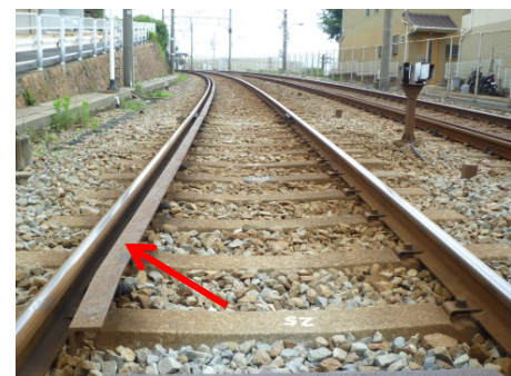
東垂水駅付近の脱線防止ガード
