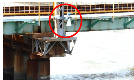
橋りょうに設置した水位計
