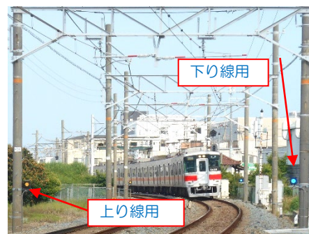
江井ヶ島駅付近の列車接近警報装置
