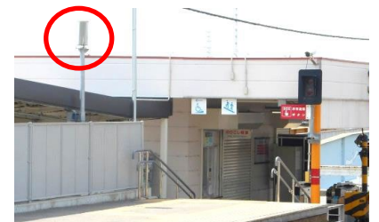
駅に設置した雨量計
